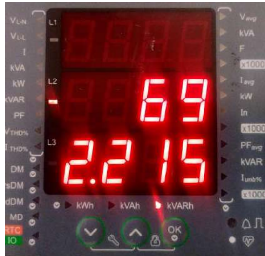
Medidor de energía utilizado en el ejemplo
